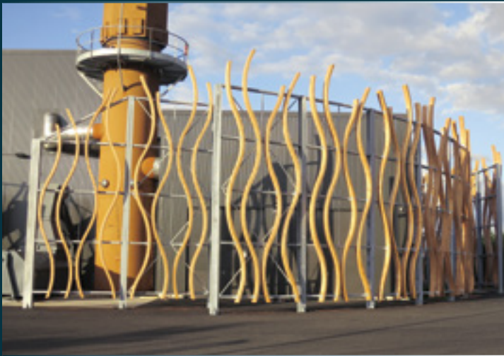
Chaufferie de Guéret
